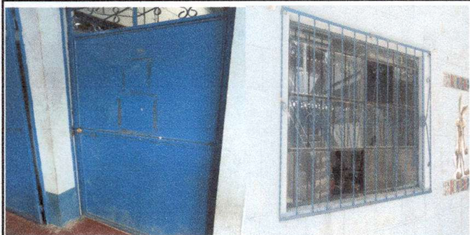
Foto 1: Módulos de aulas No. 1, 4. PUERTAS DE METAL 4.3 Sustitución de puerta, VENTANAS, 5.2 Sustitución de estructura de metal de ventanas, 5.6 Sustitución de balcones de metal.
