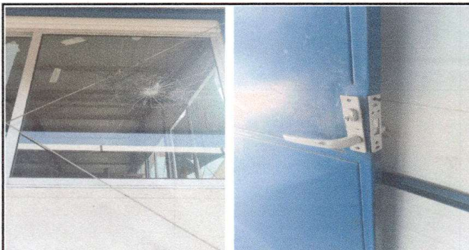
Foto 3: MODULO DE AULAS No. 2. 4. PUERTAS DE METAL, 4.2 Sustitución de chapa 5. VENTANAS, 5.5 Sustitución de vidrio.
